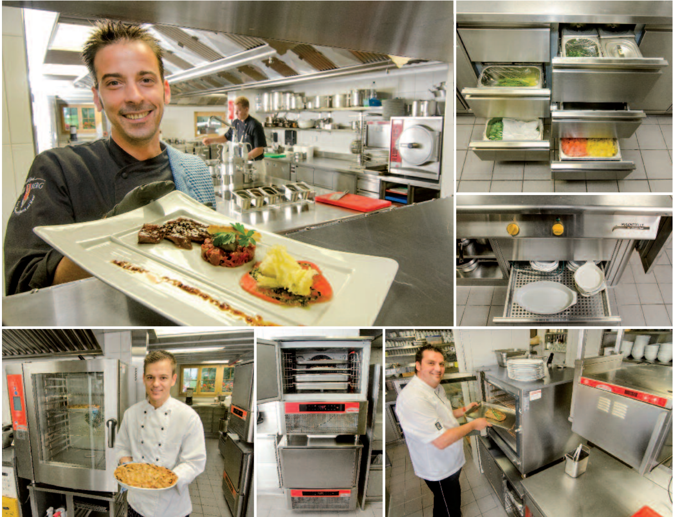
Die beiden Küchenchefs und ihr Team sind begeistert von den Möglichkeiten, welche die neue Küche bietet. Insbesondere die zwei FrigoJet Schnellkühler/Schockfroster sorgen für eine Mise-en-place-Bewirtschaftung der Spitzenklasse.
